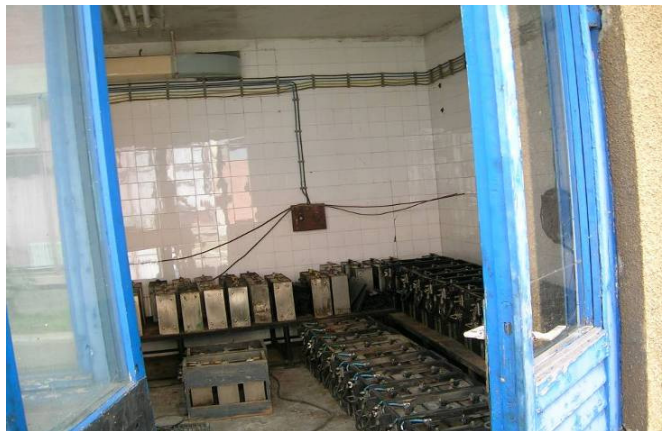
Sl.br.-42. Akumulatorska stanica
