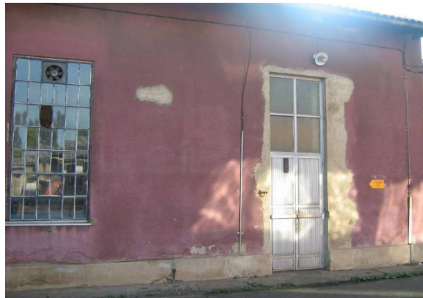
Sl br. 49- Kotlovnica
